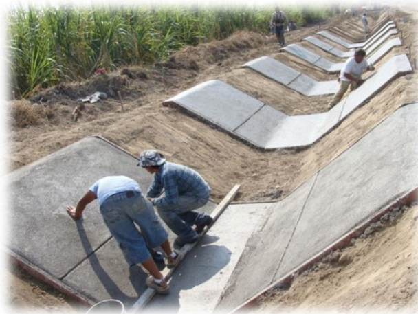
Imagen 4.3.4 superficies de trabajos inseguros
