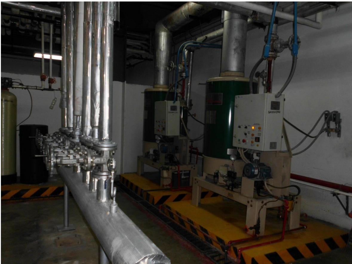
Figura 4.3. Área de calderas del Hospital “Dr. Rafael Pascacio Gamboa”.
