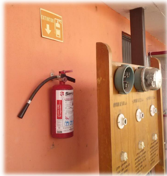
Figura 15. Extintor de la estancia
