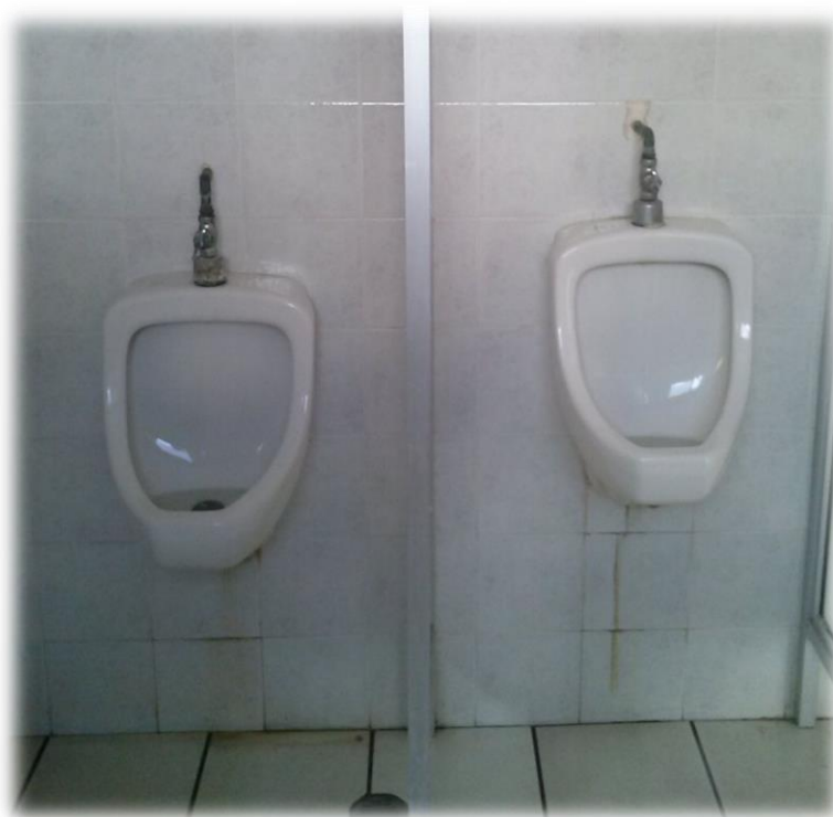
Figura 18. Mingitorios para trabajadores de cuadrilla
