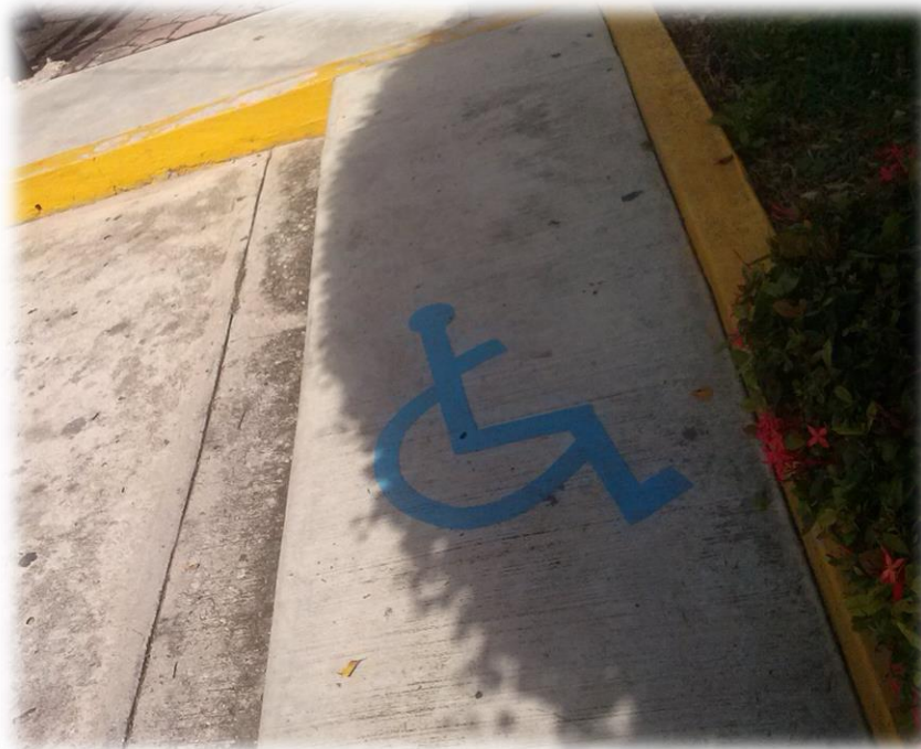
Figura 2. Rampa para discapacitados en el estacionamiento
