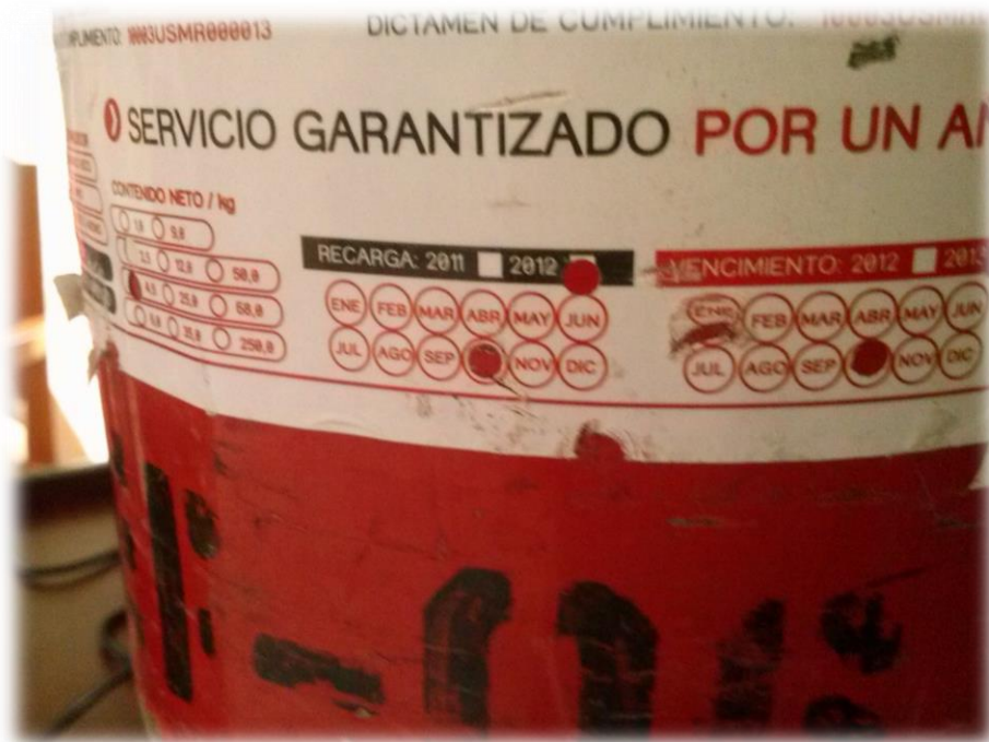
Figura 11. Etiqueta de extintor
