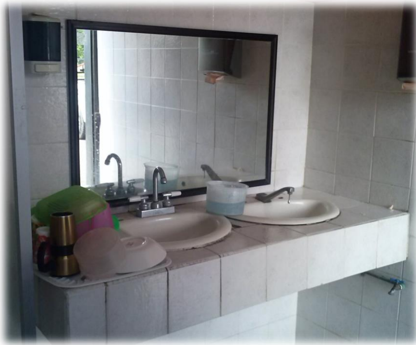
Figura 17. Lavamanos para trabajadores de cuadrilla
