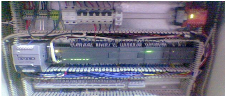
Figura 4.33. Muestra de diversos cableados utilizados en el gabinete
