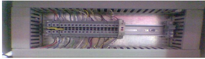
Figura 4.18. Muestra interna del gabinete de pantalla
