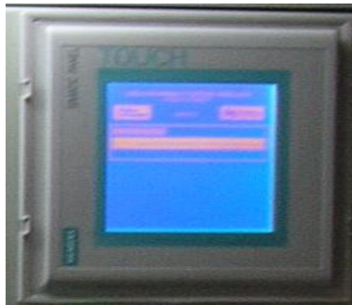
Figura 2.24. HMI marca Siemens
