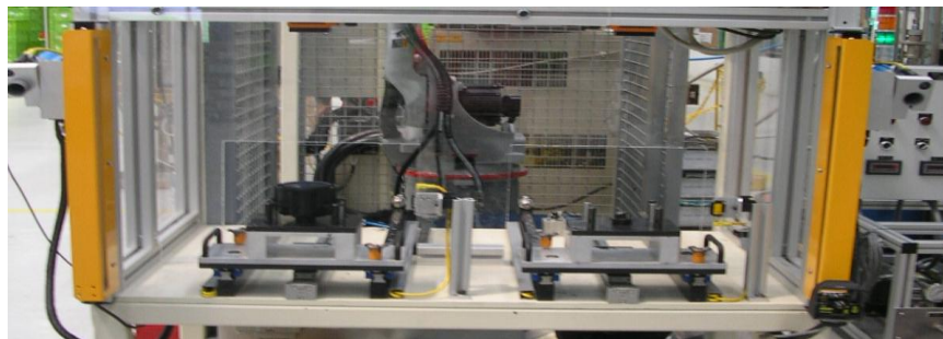
Figura 4.23. Barreras de seguridad puesta en la estación del robot
