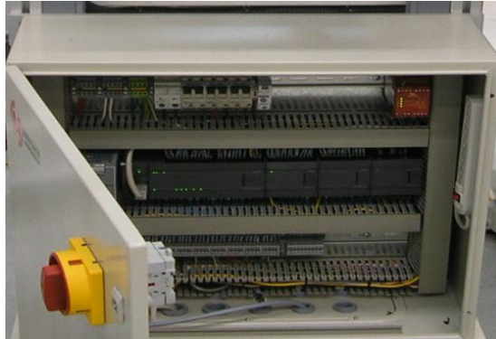
Figura 4.11. Parte Central del Gabinete de control PLC
