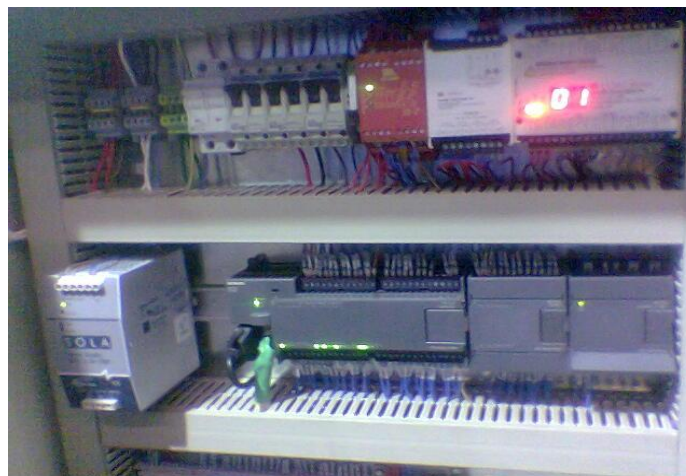
Figura 4.7. Gabinete de Control
