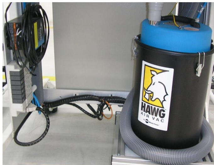
Figura 3.3. Contenedor de Contaminantes
