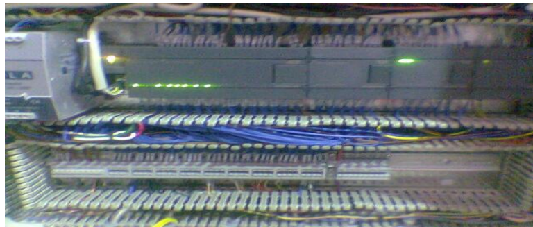
Figura 4.9. Uso de las canaletas en las platinas para los gabinetes de control
