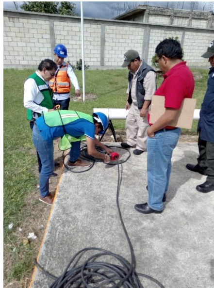
Fig. 3.18 Medición de descarga de autotanques
