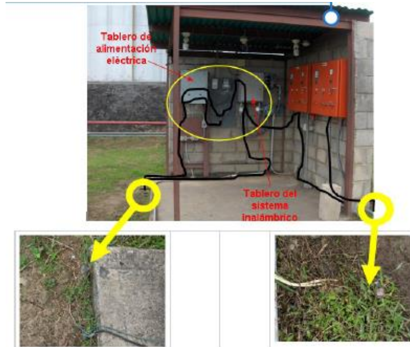
Fig. 3.6 Conexión a tierra en la caseta.
