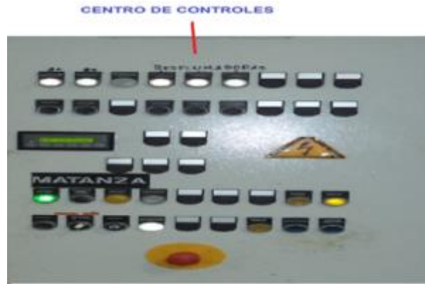
IMAGEN 5.6.2 CENTRO DE CONTROL
