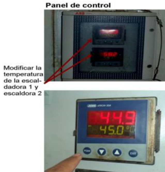
IMAGEN 5.3.3 PANEL DE CONTROL ESCALDADORA.
