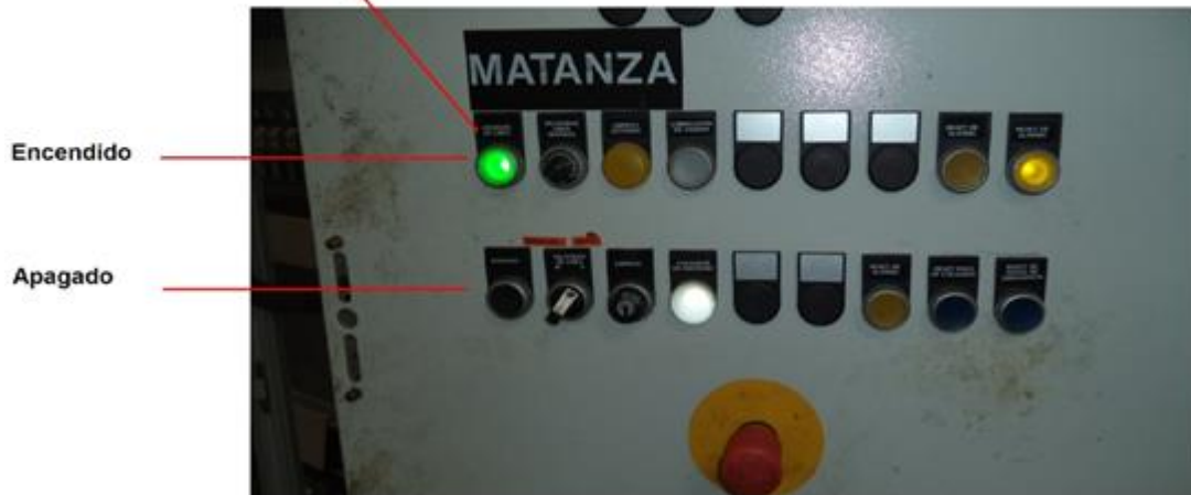
IMAGEN 5..2.3 MATADOR: CENTRO DE CONTROL.
