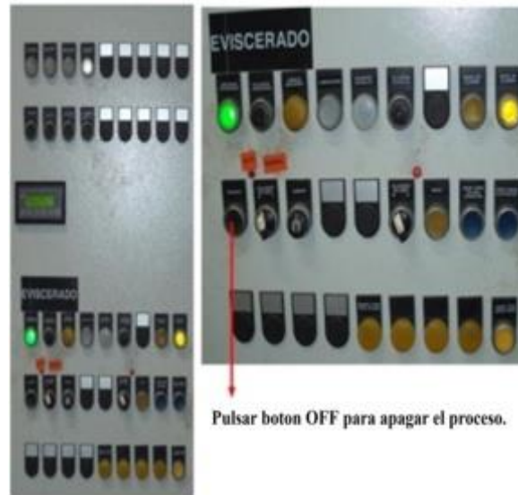
IMAGEN 5.14.5 CONTROL CENTRAL DE MAQUINAS.
