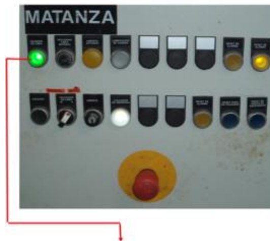
ENCENDIDO DE LA LINEA EN CCM
