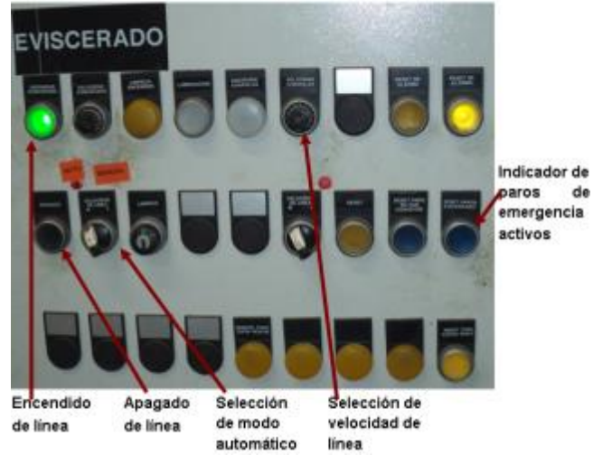
IMAGEN 5.8.7 INDICADORES DE ENCENDIDO.
