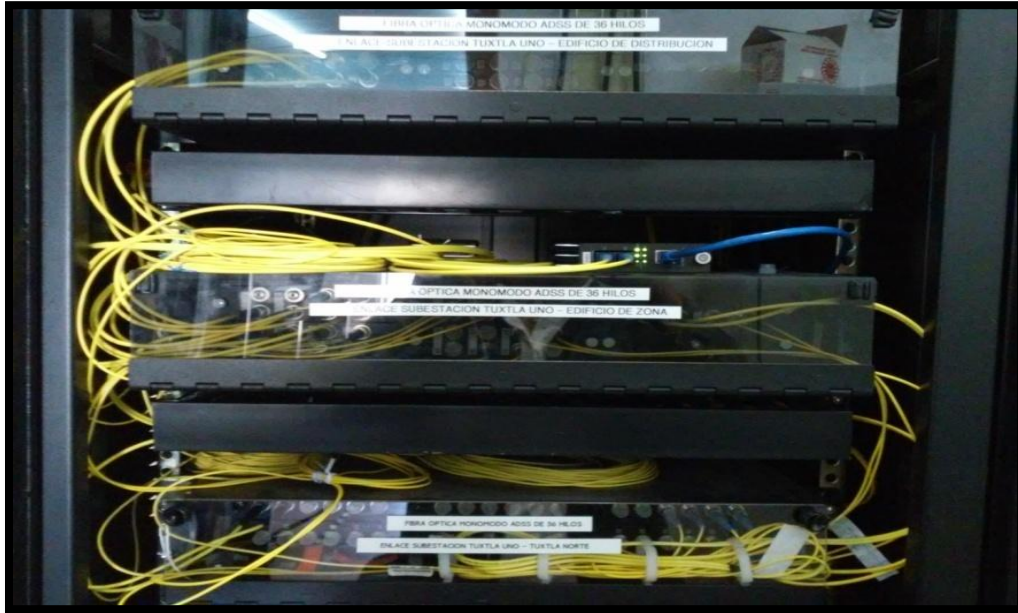
Figura 6.1 Instalación de los equipos de comunicación de datos
