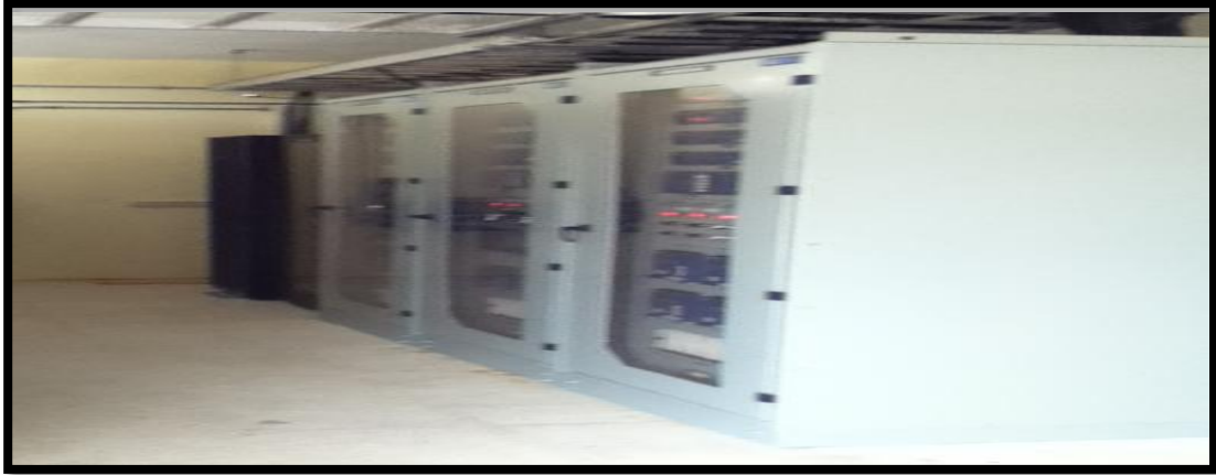
Figura 3.6 Tableros de relevadores industriales
