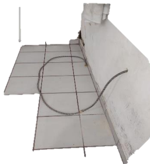
Ilustración 7. Perforación de la pared y línea de suministro de gas.
