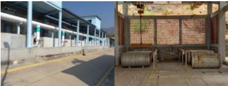
I) Área de cloración y almacenamiento de gas cloro.
