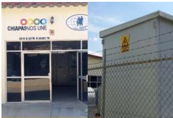
F) Área de control eléctrico y de máquinas.
