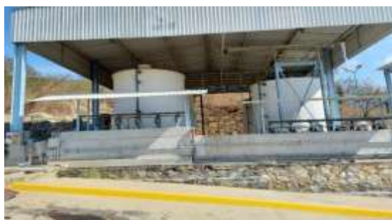
Figura 15.1. Tanques de almacenamiento de sustancias químicas.
