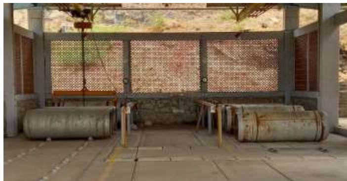
Figura 15.7. Almacenamiento de cilindros de 907 kg de gas cloro.
