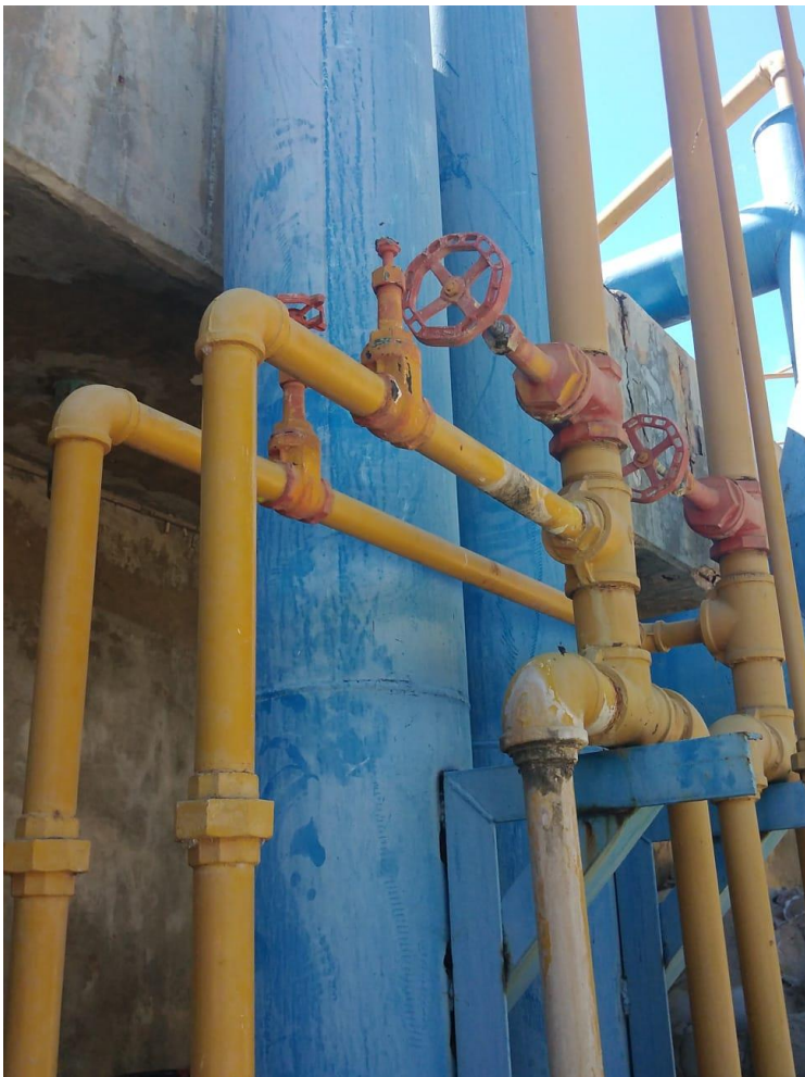
Anexo V: Foto de las válvulas rotas
