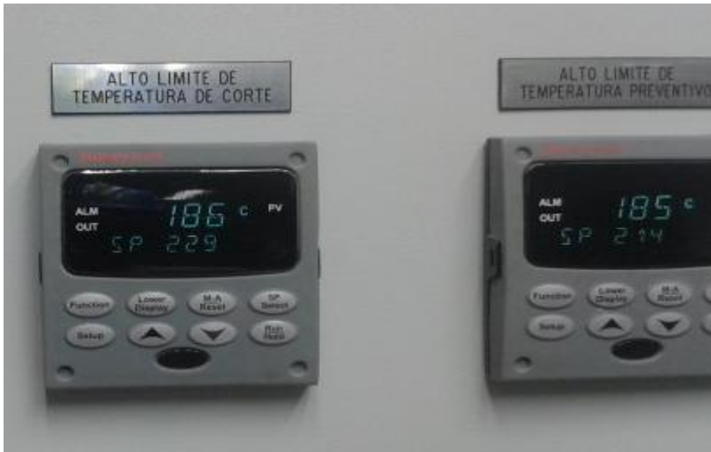
Figura 2.8 controlador funcionando al 100%
