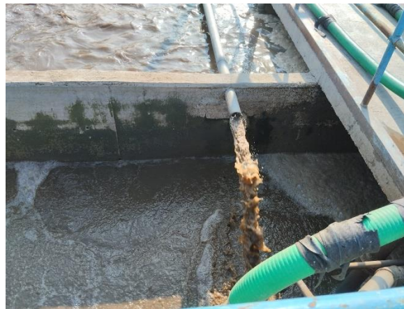
Figura 20. Purga de lodos del sedimentador secundario de la planta de 40 L/s. (Elaboración propia).
