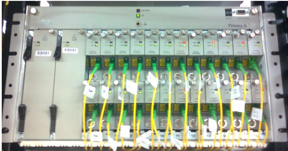
Fig. 3.16 - Chasis con sus elementos correspondientes, algunos con el nivel balanceado, podemos ver que hay algunos transmisores alarmados.
