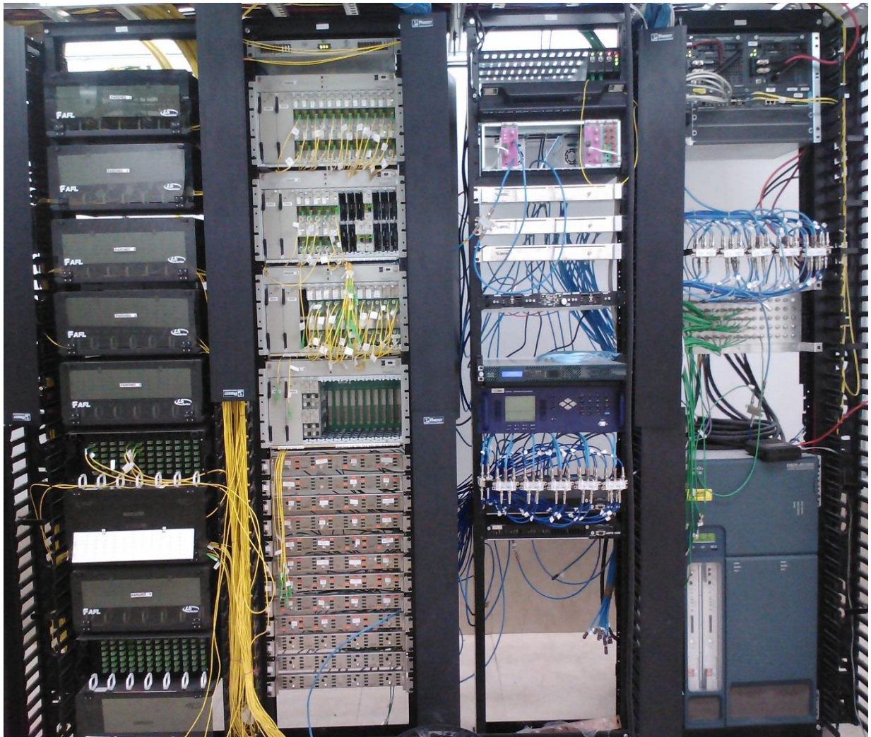
Fig. 30 - HOB terminado funcionando.
