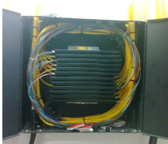
Fig. 3.1 - Este es un baúl abierto que muestra los buffers de una parte del HOB.
