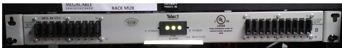
Fig. 3.29 - Panel de fusible con sus diez switches en uso. Los fusibles que comúnmente se usan en el HOB son de 15 Amperes.
