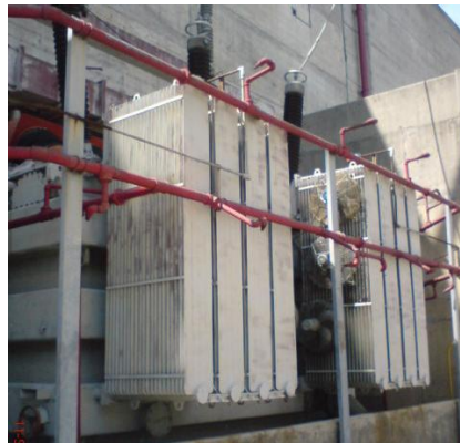
Fig. 4.11 Transformador de potencia C. H. Peñitas
