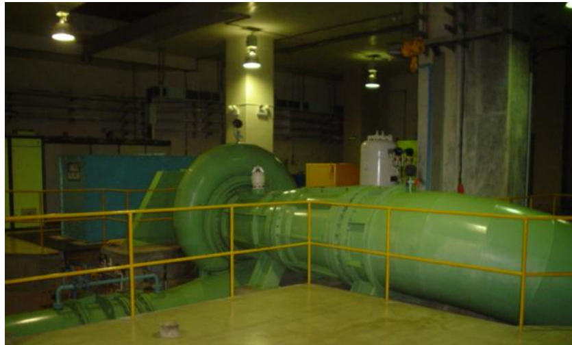
Fig. 4.6 Turbina Auxiliar C. H. Peñitas
