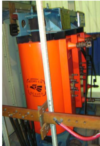
Fig. 6.11.1 Transformador de frenado
