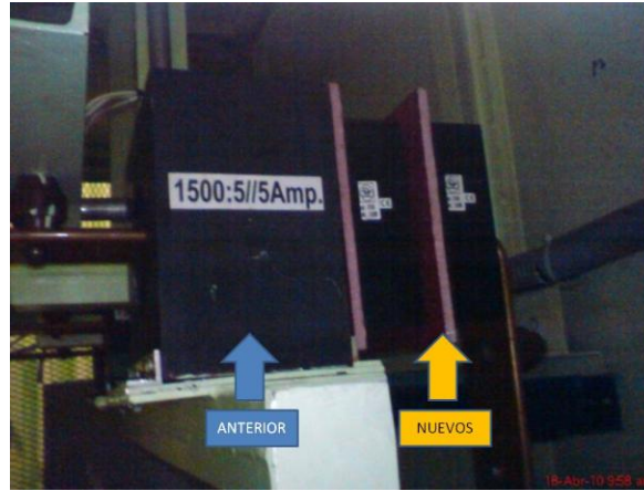
Fig. 6.10.2.1.1 Transformador de corriente (TC'S)
