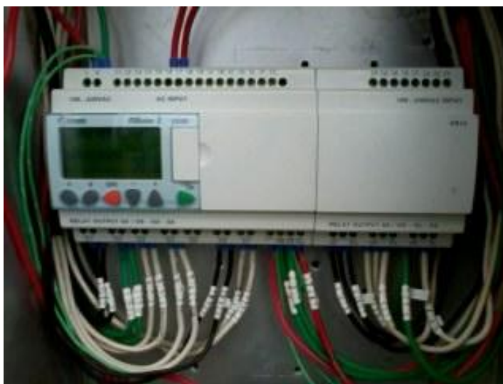
Figura 4.11 PLC funcionando y cableado
