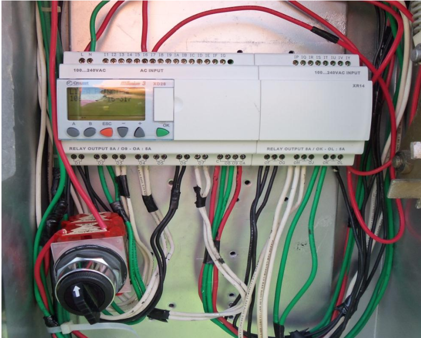
Imagen anexo 3 PLC en operación automático con paro de emergencia
