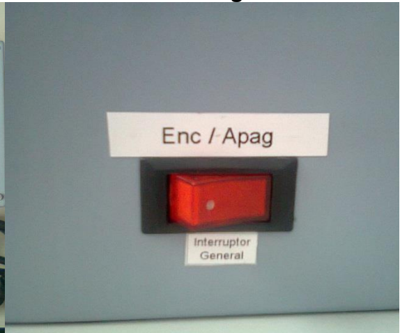
Interruptor general del gabinete.
