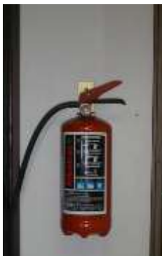
Extintor sin señalamiento en el Departamento Jurídico.
