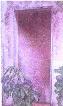
Puerta sin señalamiento en el Área de Banco de Bateria.
