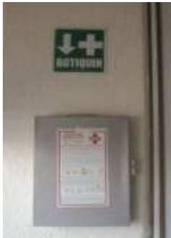
Botiquín con señalamiento
