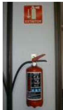
Extintor con señalamiento en el departamento Jurídico
