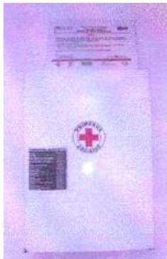
Botiquín sin señalamiento en el Departamento Jurídico.
