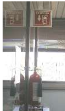
Extintor con señalamiento
