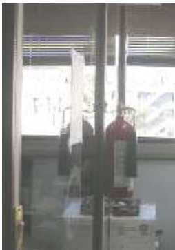
Extintor sin señalamiento en el Departamento de Informática.
