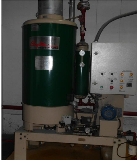
Figura 4.11 Generador de vapor del hospital.
