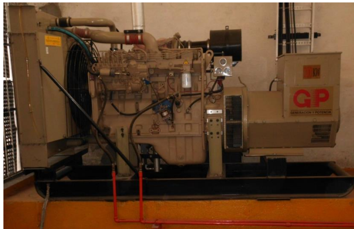
Figura 4.9 Planta de emergencia del hospital.
