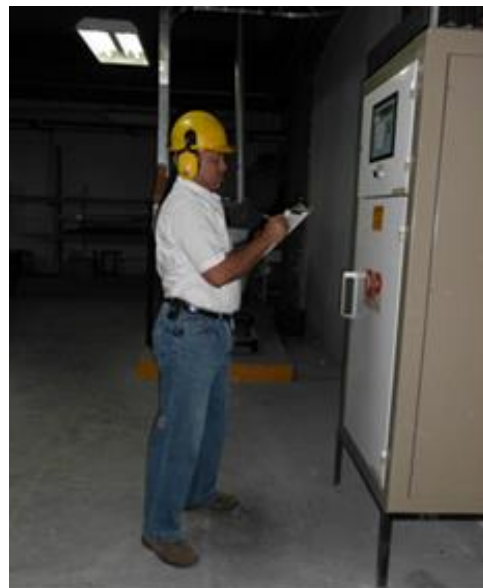
Figura 4.10 Tablero de control.
