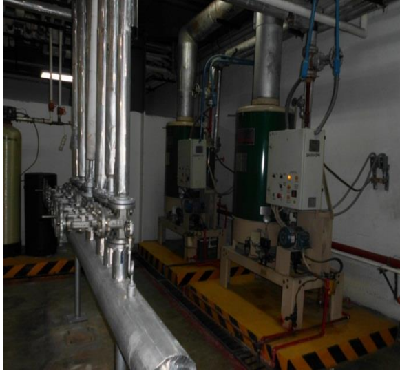
Casa de máquinas del hospital.
