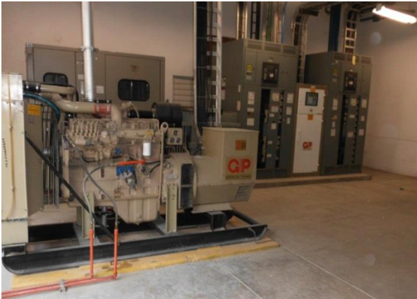
Planta de emergencia.
