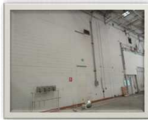
FIGURA 5.1 PAREDES Y TUBERIAS LIBRES DE CONTAMINACIÓN. (FUENTE: INVESTIGACION PROPIA)
