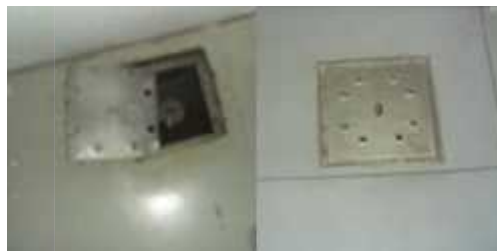
FIGURA 5.17 REGISTRO DE DRENAJES (FUENTE: INVESTIGACIÓN PROPIA).
