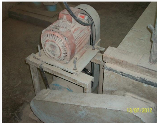
Figura 5.16 Deterioro de equipos por descuido. (Fuente: Elaboración Propia).
