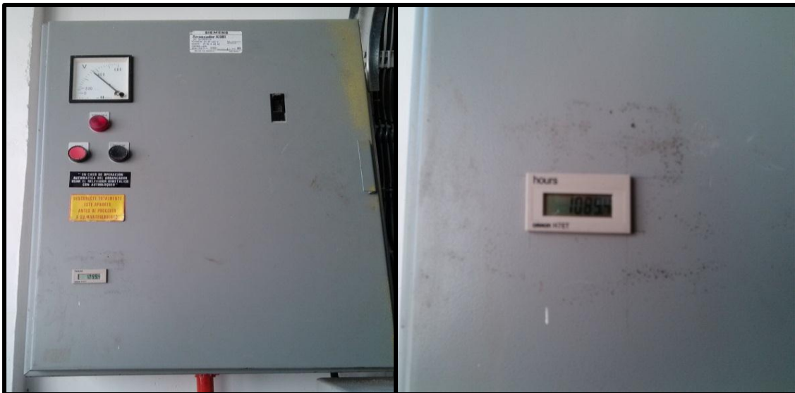
Figura 5.25 Horómetro de la limpia en el arrancador del elevador de cangilones 1 y 2 (Fuente: Elaboración propia)
