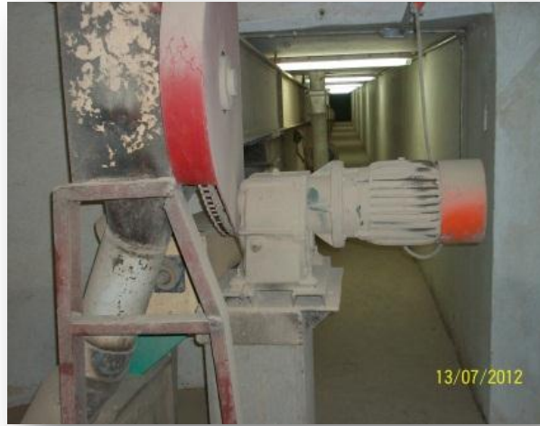
Figura 5.13 Falta de limpieza a motores. (Fuente: Elaboración Propia).
