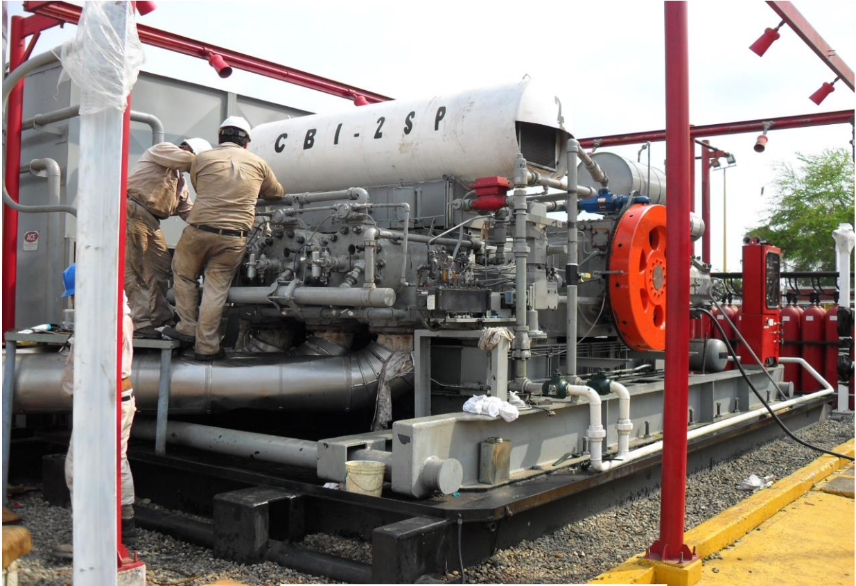
Compresora Marca Cameron
