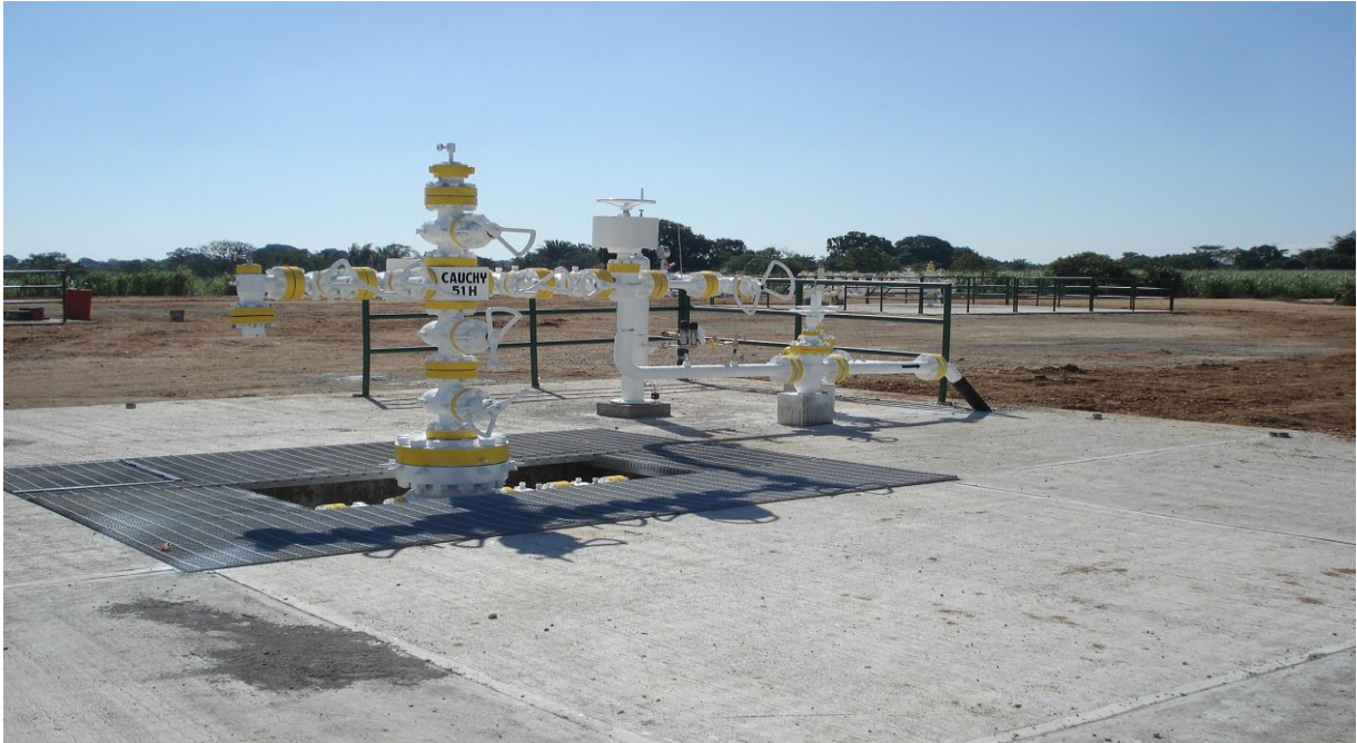
Árbol de Válvulas de Pozo
