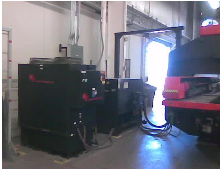
Fig. 2.23 Schiller y unidad hidráulica.
