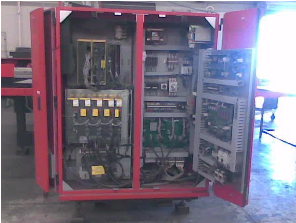
Fig. 2.21 Armario eléctrico principal de la punzonadora.
