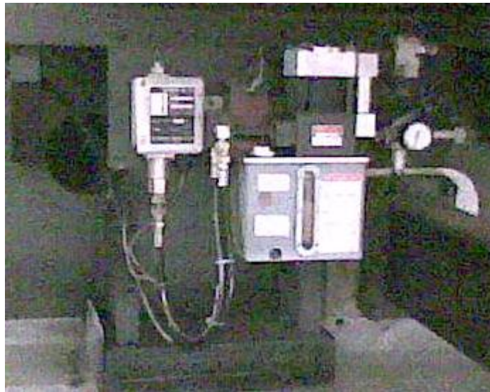
Fig. 2.7 Unidad hidráulica de los clamps.
