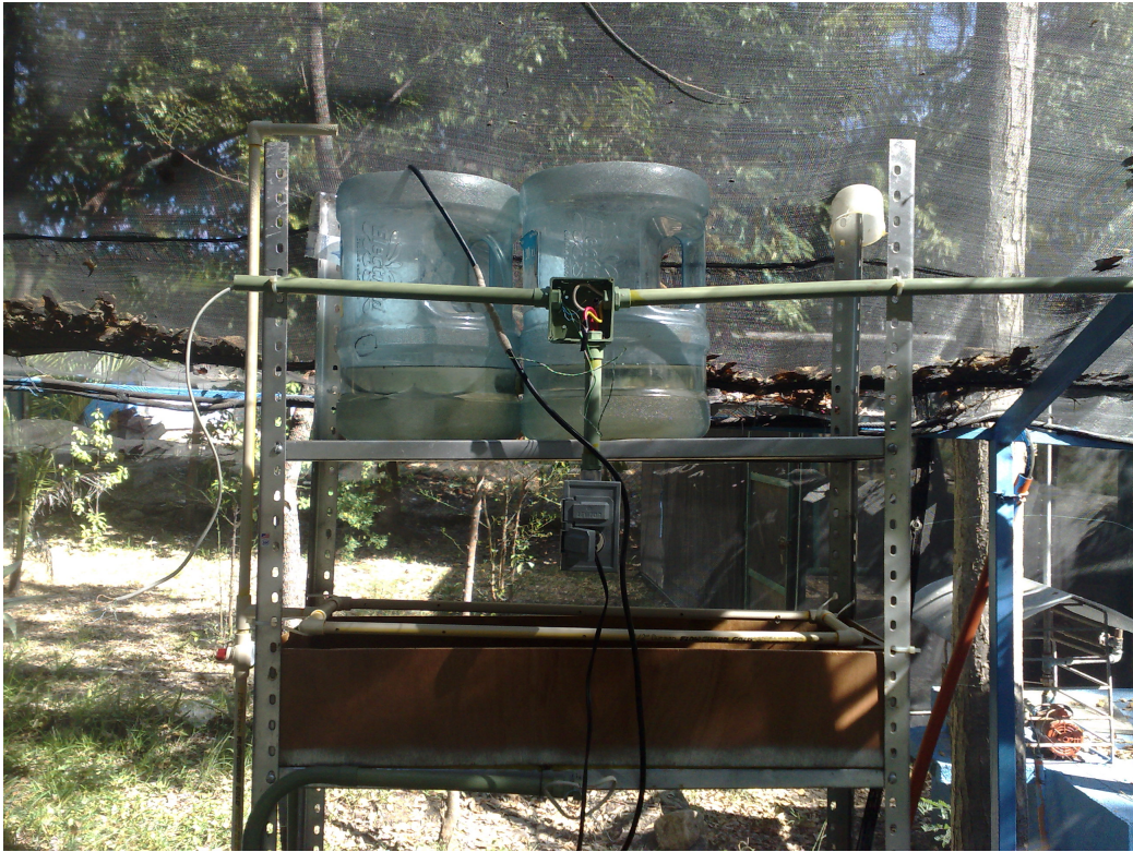
Figura 5.7: Tanque para el sistema de riego
