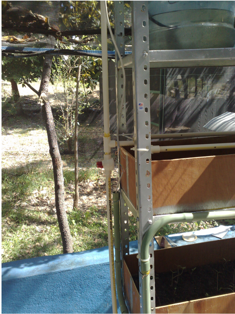
Figura 5.8: Sistema de tuberías
