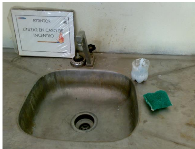
Foto 11 Instalaciones de lavado de manos inadecuadas.
