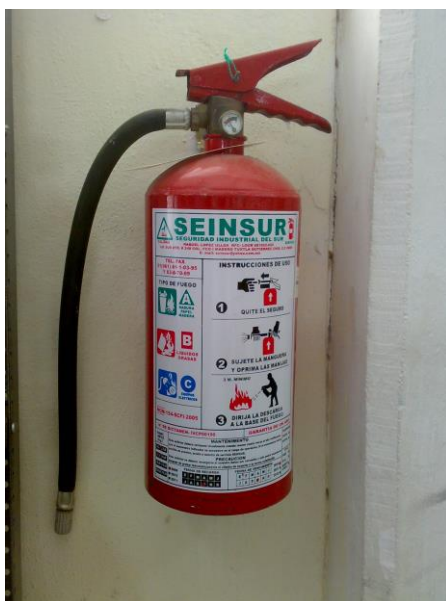
Foto 18 Extintor para laboratorio.
