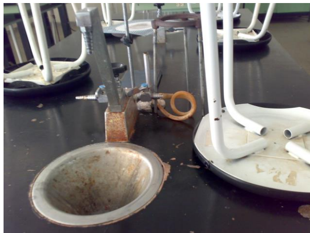
Foto 14. Fuga de gas en las mesas de trabajo
