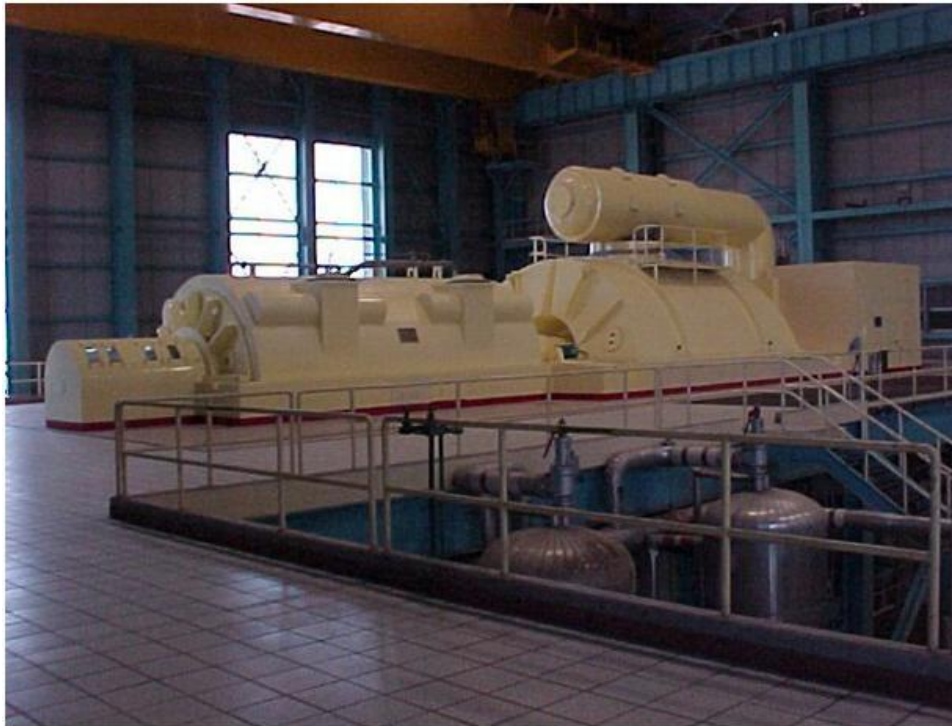
Figura 10. Vista completa del Turbogenerador Eléctrico
