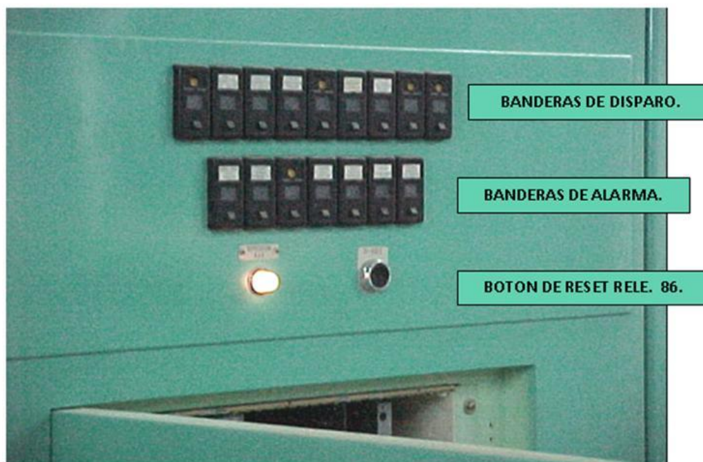
Figura 13. Tablero de Alarmas y Disparos de RAV
