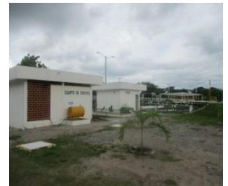
Imagen 2.8 instalaciones de la PTAR.
