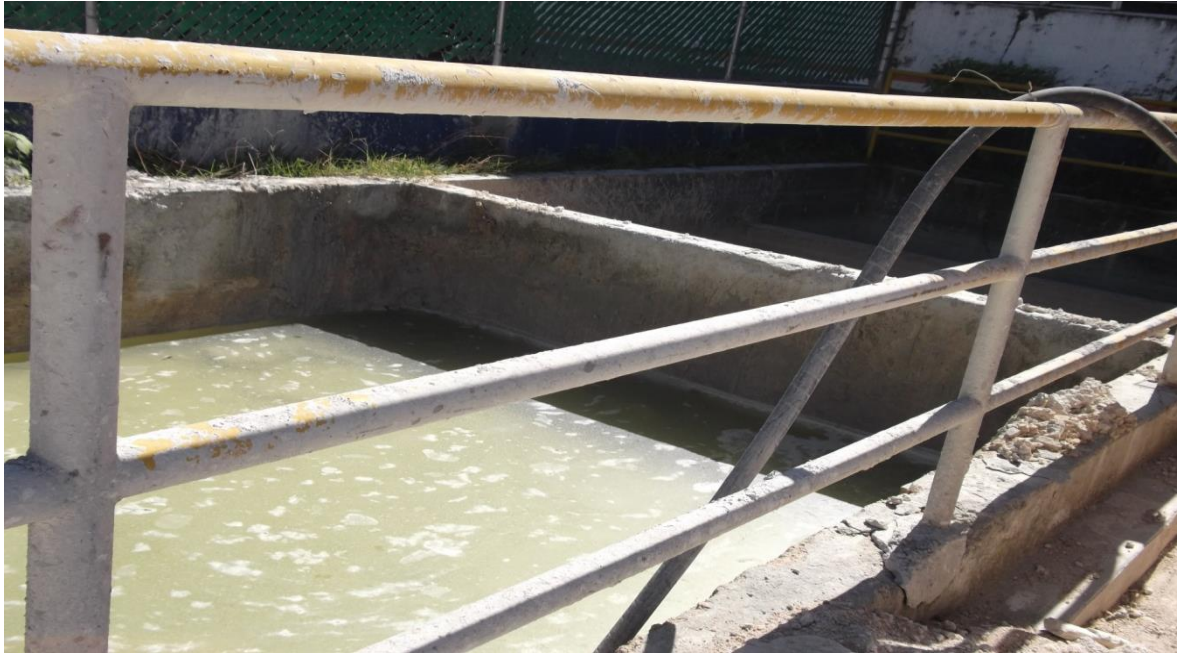
Figura 6.4.7 Fosa de lavado sin señalización, pequeña y en mal estado
