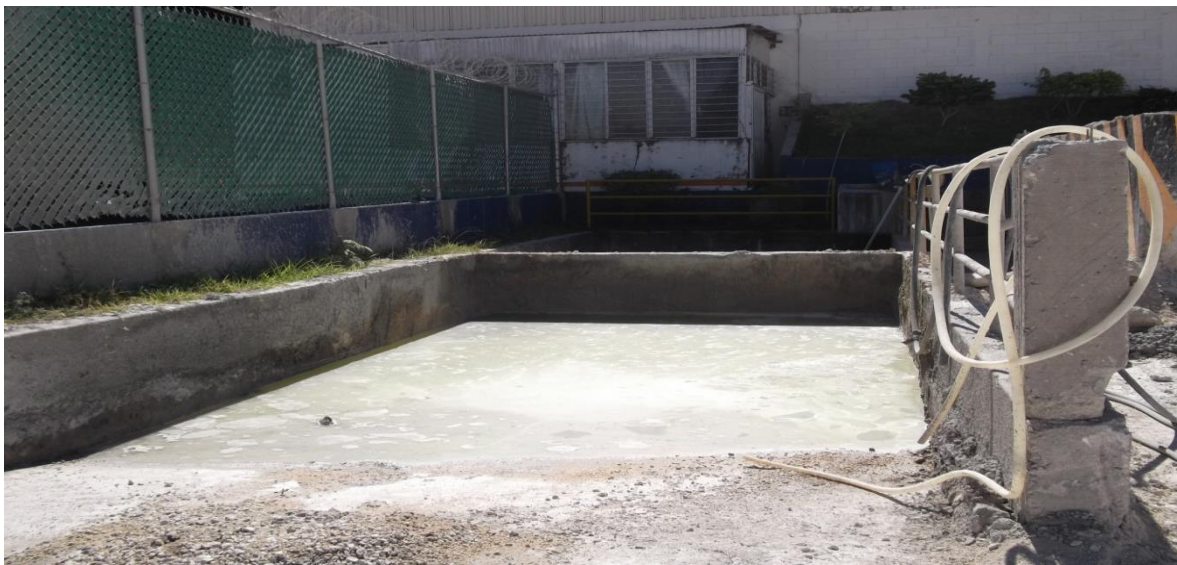
Figura 6.4.6 Fosa de lavado sin señalización, pequeña y en mal estado
