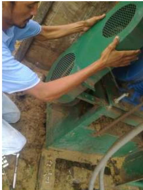
Figura 6.7 Cambio de roscas barridas al cubre cadena por la corrosión
