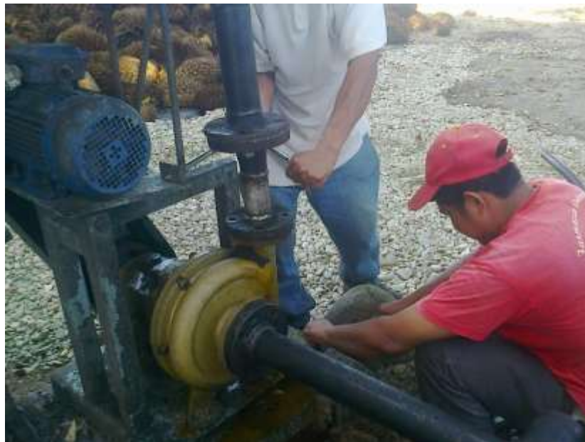
Figura 6.5 Bomba de lodos cambio de empaques por fuga
