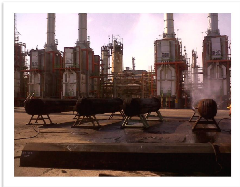
1.- Mantenimiento de los intercambiadores de calor con extracción de núcleos en marzo del 2012.
