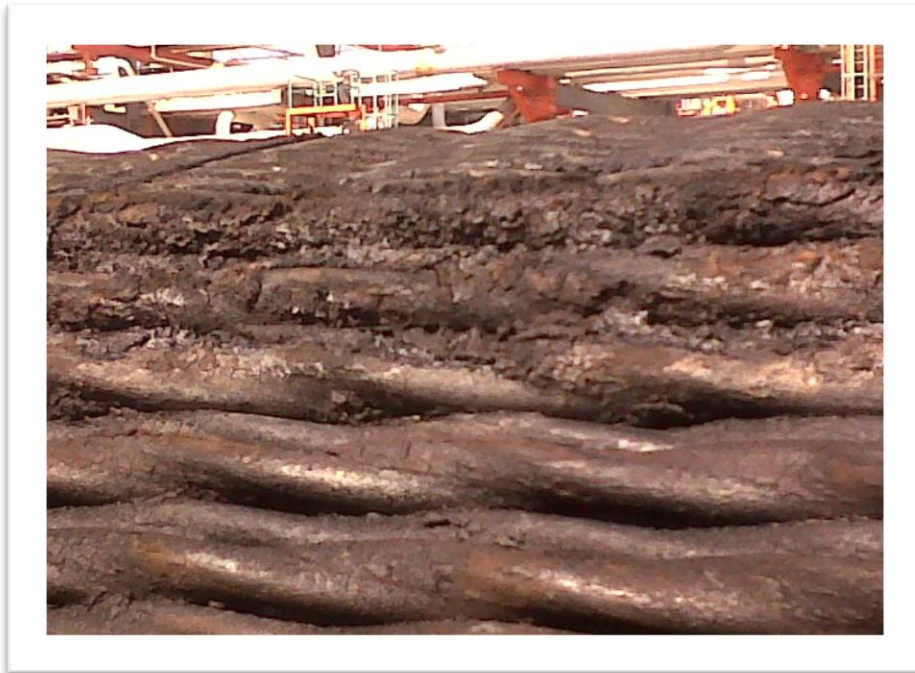
4.- Corrosión y ensuciamiento en el lado tubos del intercambiador de calor A. Los tubos seriamente gastados, con alto grado de incrustaciones.
