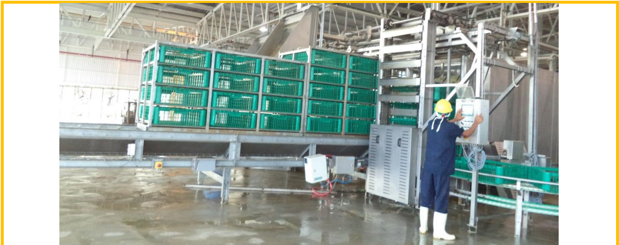
Salida de racks con jaulas vacías
