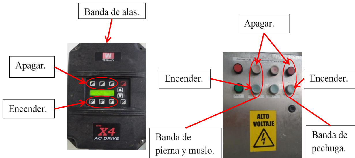
Figura 13.- Encendido de las bandas.
