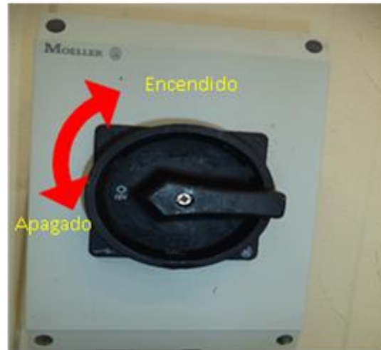
Figura 2: Interruptor de la separadora EMI.
