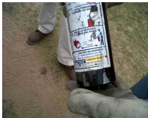
Fotografía 4.8, extintor vencido desde septiembre de 2011.
