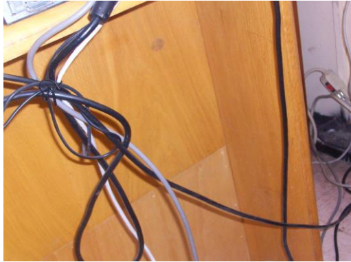
Fotografía 4.3, cables en desorden.
