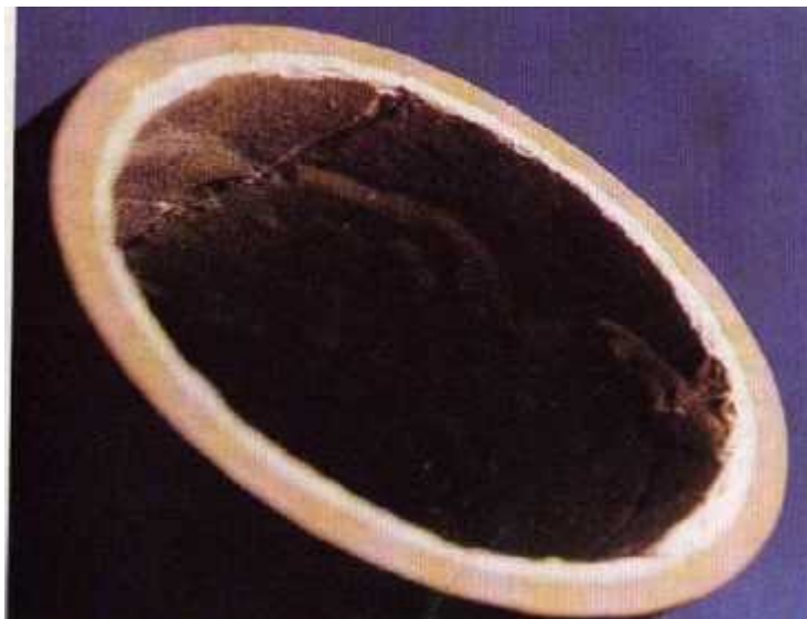
FIGURA 5. DEPOSITO DE CARBONATO DE CALCIO
