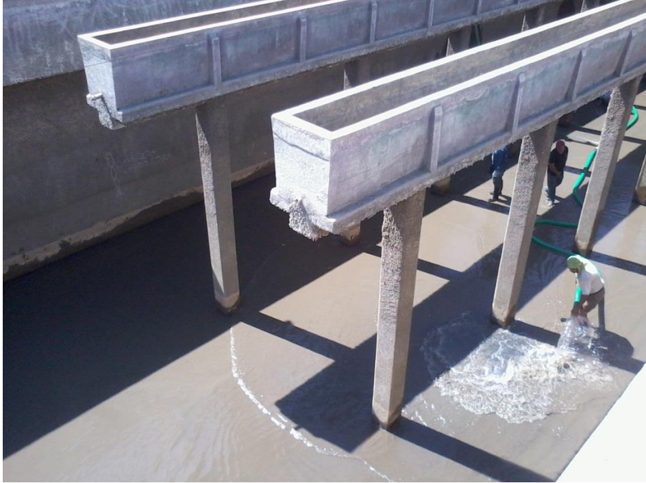
Figura 29. Limpieza de los filtros planta potabilizadora número 2
