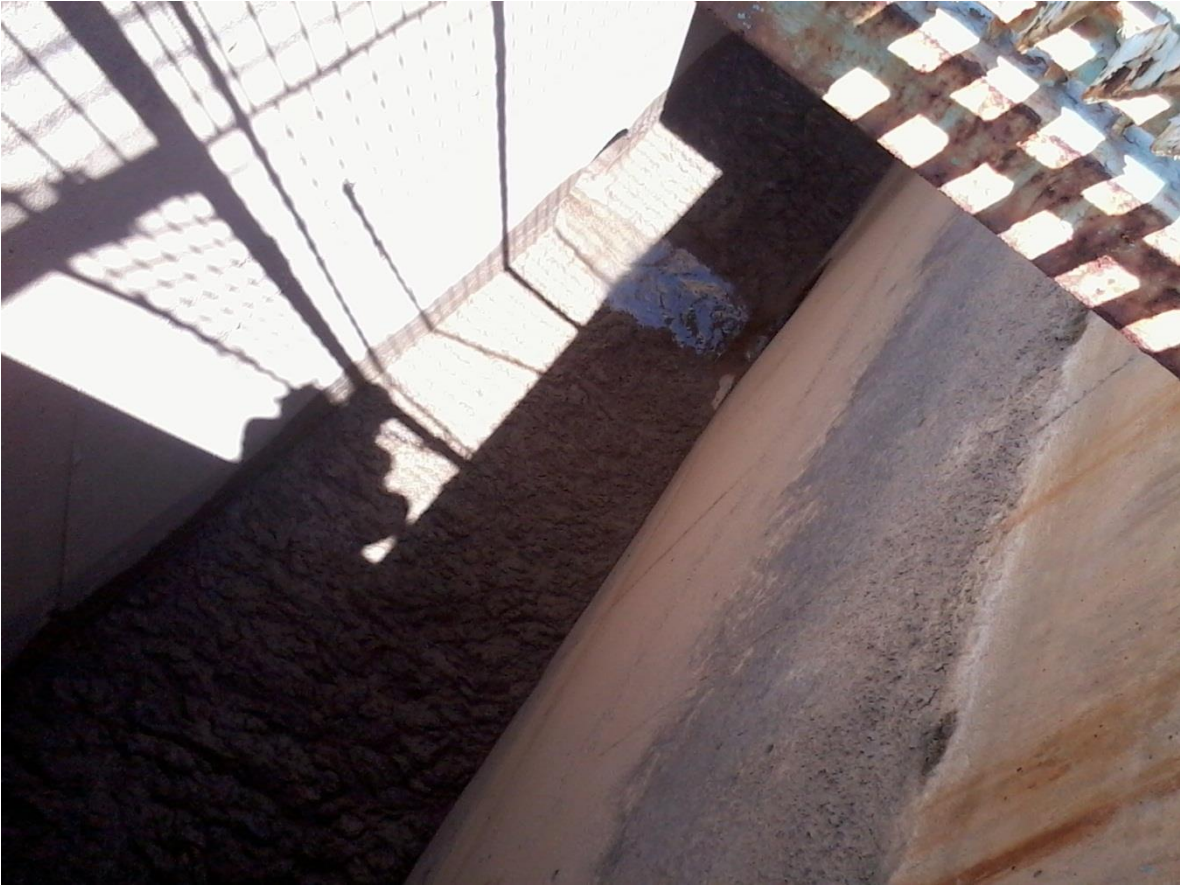
Figura 31. Limpieza de las canaletas antes de sedimentación (después de floculación)
