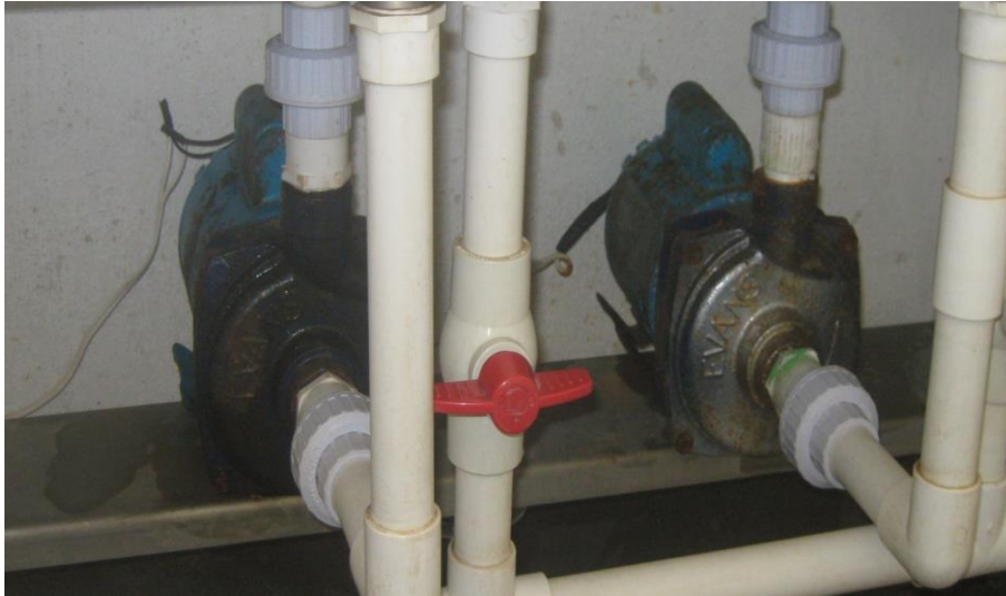
Figura 4.2 Bombas caustico de 1Hp.
