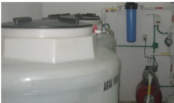
Figura 2.6. Agua bombeado de la cisterna.
