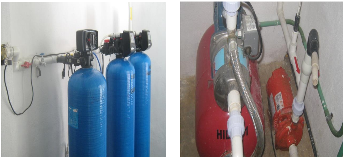
Figura 5.2 Equipos después de haber realizado el mantenimiento.
