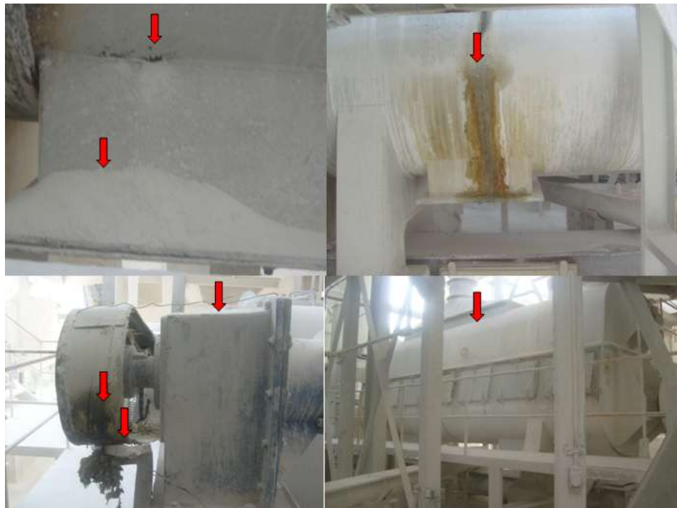
Figura 4.11. Condiciones de la Hidratadora de Doble Paso.
