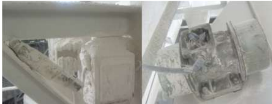
Figura 5.7. Condiciones del sistema eléctrico de los motores del Transportados 19.
