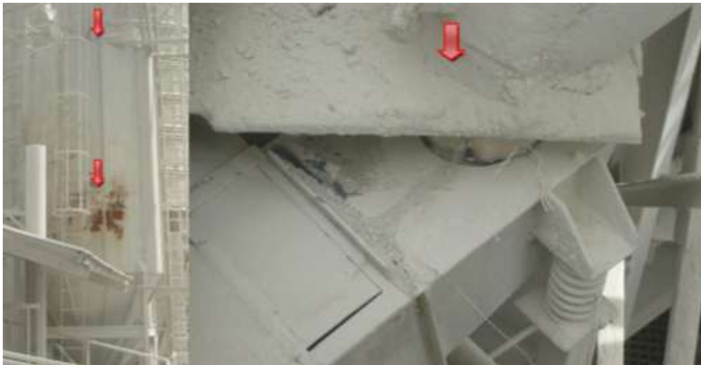
Figura 4.7. Condiciones del silo 3.
