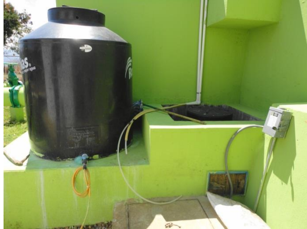
Figura 4.2 Artículos mal ubicados debajo del tanque de recepción
