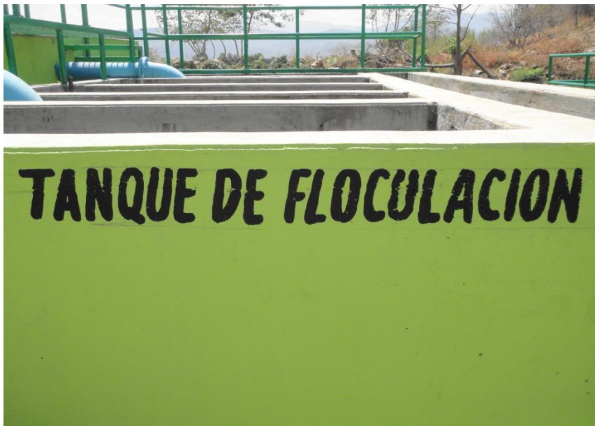
Figura 2.3 tanque de floculación
