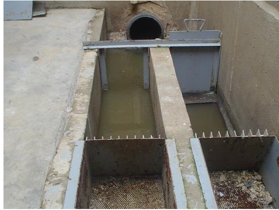
FIGURA 4. Desarenador instalado en la Planta de tratamiento del Aeropuerto Internacional “Ángel Albino Corzo. FUENTE: SEMAVINH.
