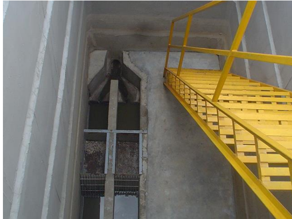
FIGURA 2.- Vista superior de las rejas de barras instaladas en la Planta de tratamiento del Aeropuerto Internacional “Ángel Albino Corzo. FUENTE: SEMAVINH.
