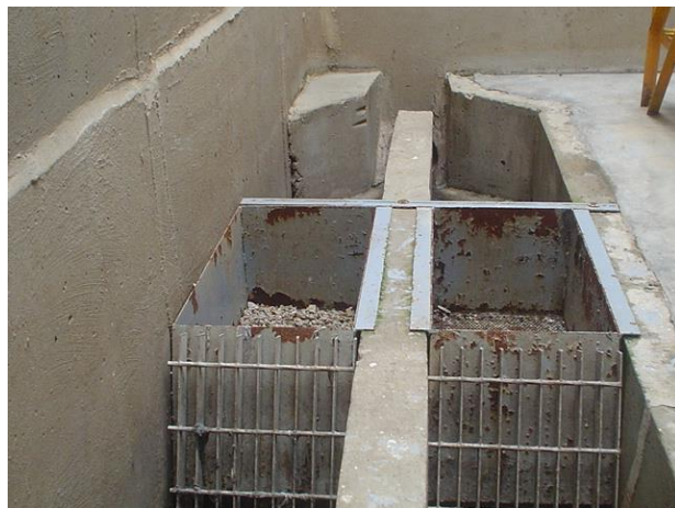
FIGURA 1.- Reja de barras instalada en la planta de tratamiento del aeropuerto internacional “Ángel Albino Corzo”. Fuente: SEMAVINH
