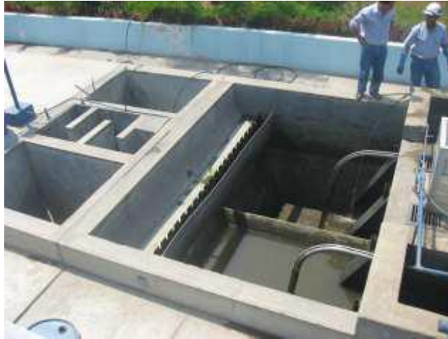
FIGURA No.9. Cámara de clarificación – sedimentación instalada en una planta. FUENTE: sedapal, 2011
